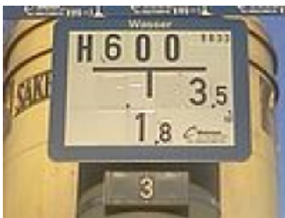
Blaues Hydrantenschild zum Hinweis, dass dieser Hydrant zusätzlich Be- und/oder Entlüftungseinrichtungen für die Leitungswartung besitzt
