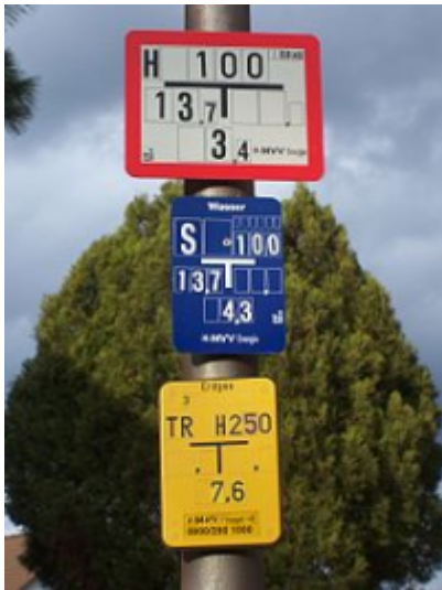
Hinweisschilder für Hydrant, Wasserschieber und Erdgas
